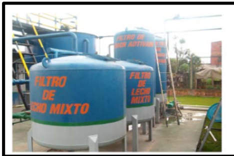
Figura 3. Filtros de tratamientos de agua industrial torres de enfriamiento. Empresa Grifería y Complementos S.A. Funza, Cundinamarca. (los autores)
