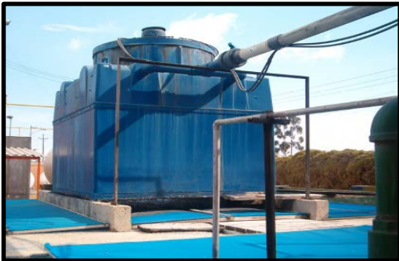
Figura 1. Torres de enfriamiento línea de inyección mueble sanitario. Empresa Grifería y Complementos S.A. Funza, Cundinamarca. (Los autores).
