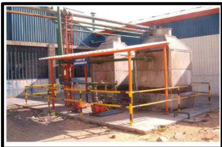
Figura 2. Torres de enfriamiento líneas de fundición. Empresa Grifería y Complementos S.A. Funza, Cundinamarca (los autores).
