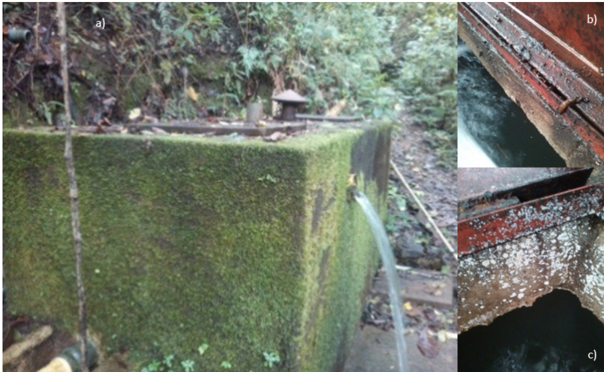
Figura 5 condición del tanque a) musgo y liquen en paredes laterales, b) presencia de
