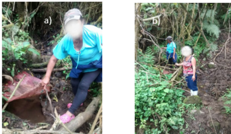
Figura 4 Cerritos a) estado actual de la bocatoma b) sendero labrado por el ganado Fuente: autor
