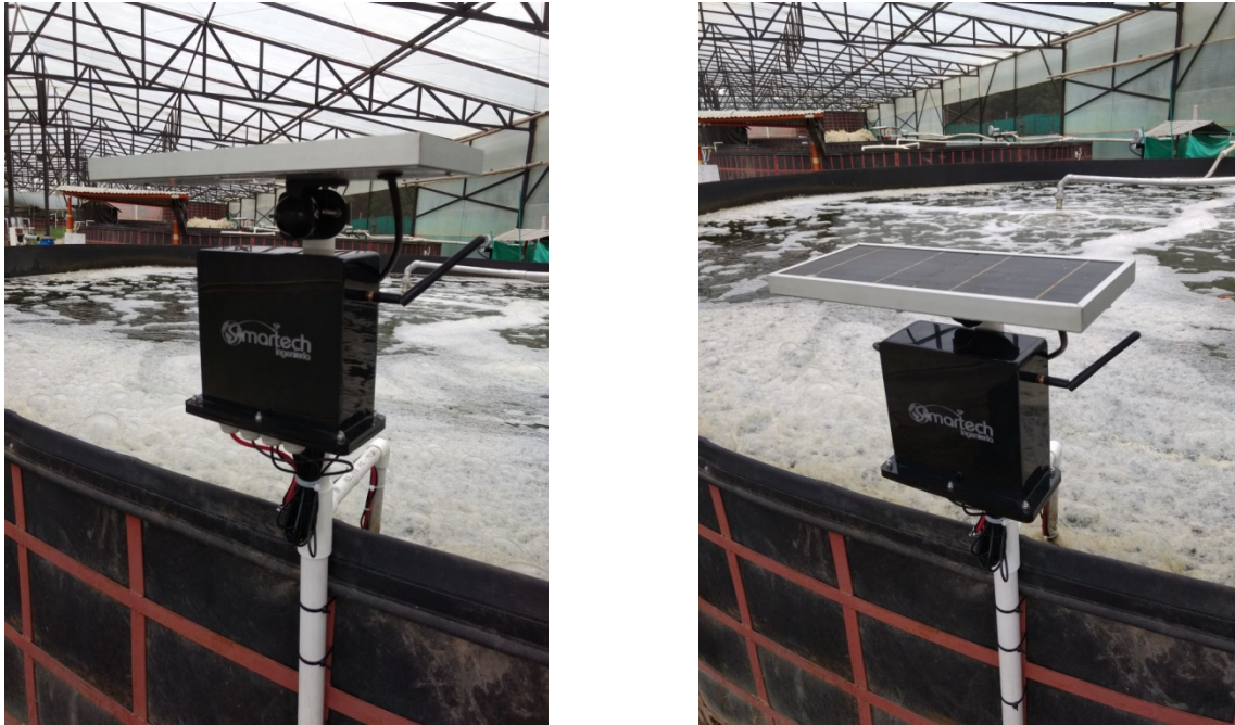
Figura 3. Prototipo Completo de Aquasmart instalado en una aplicación particular y pruebas de funcionamiento.
