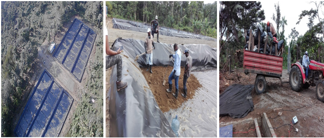
Panorámica de las 6 celdas inicio de operación en la celda descargue de vehículo recolector
